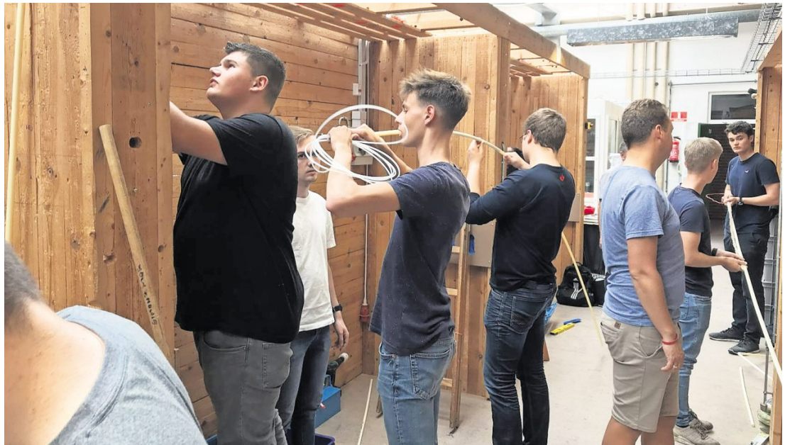
„Über den Tellerrand hinausschauen“: Erstmals durften auch BBS-Schüler des technischen Gymnasiums an einem Erasmus-Austausch teilnehmen. Es ging nach Dänemark. Gemeinsam mit dänischen Schülern und arbeiteten sie vor Ort an einer Hausinstallation – und bewiesen dabei ihr Können. Foto: red
